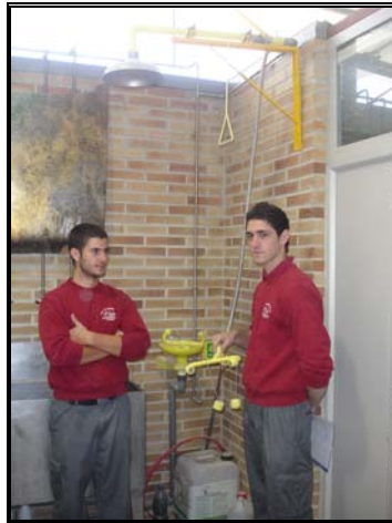
Duchas y lavaojos de emergencia
