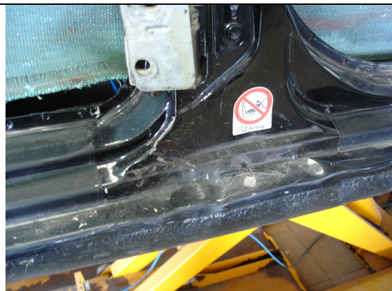
Detección de pliegue en el pilar B derecho
