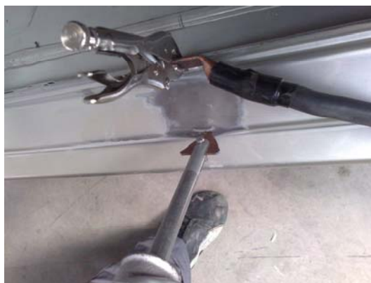
(Una vez lijada la zona, soldamos la estrella y tiramos en sentido contrario al de la dirección del golpe hasta extraerlo. Posteriormente lijamos la zona)
