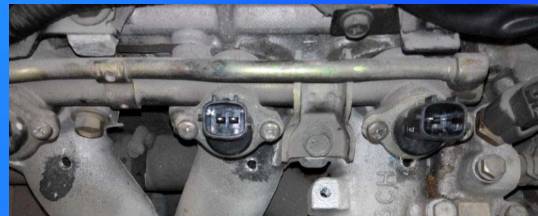
Realizamos los orificios de los inyectores y colocamos el colector de admisión
