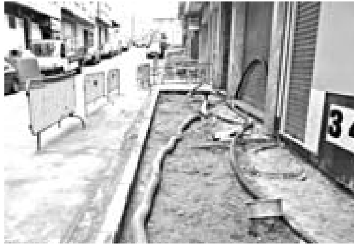
Unha imaxe das obras na Rúa Rosalía de Castro para mellorar a rede de saneamento
