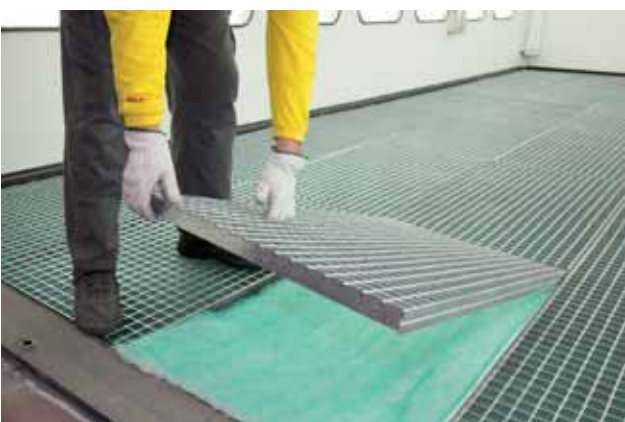
► Sustitución de filtros paint stop
