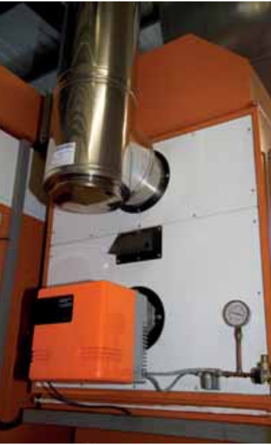
► Quemador y chimenea
