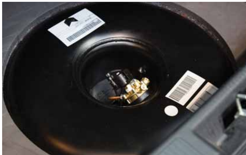
▶ Depósito de GLP y electroválvula de entrada y salida del gas
