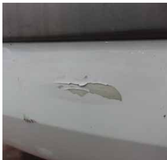
► Falta de adherencia
