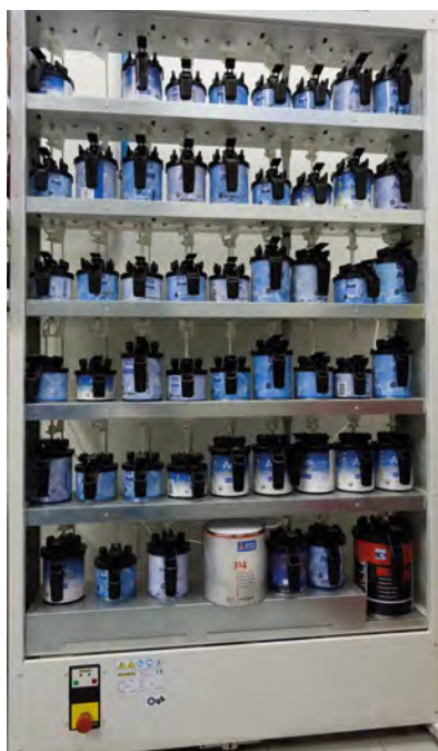
► Armario sin calefactar
