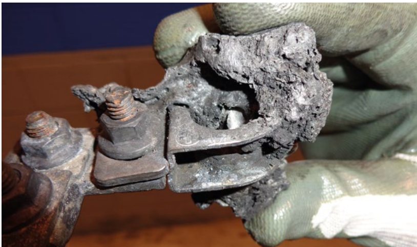
► Borne de conexión a batería afectado
