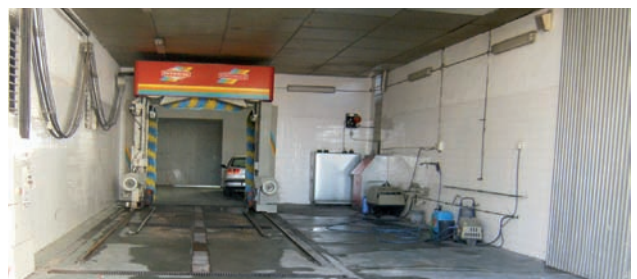
▲ Tunel de lavado
